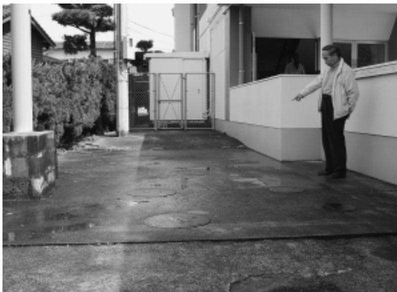
多良中学校浄化槽
