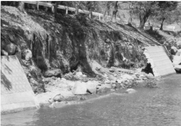
町道災害（破瀬ノ浦）
