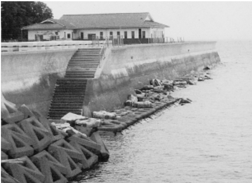
台風13号被害（竹崎処理場護岸）
