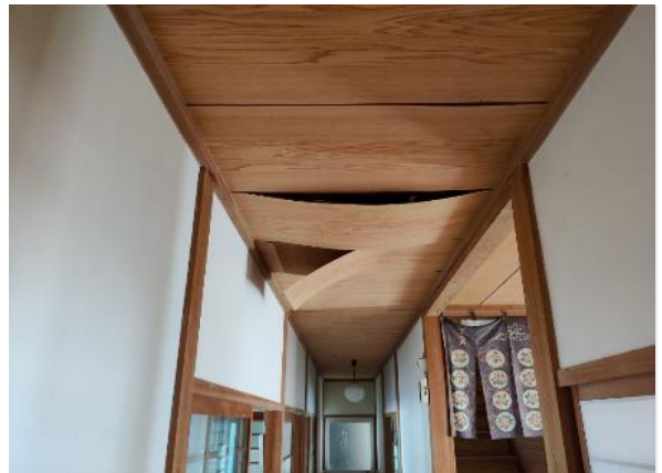
天井の剥がれ
