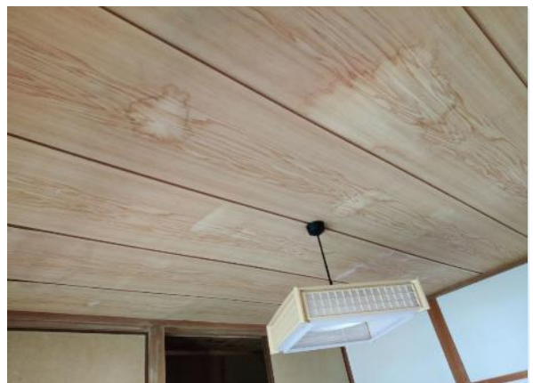
天井のシミ（一部）
