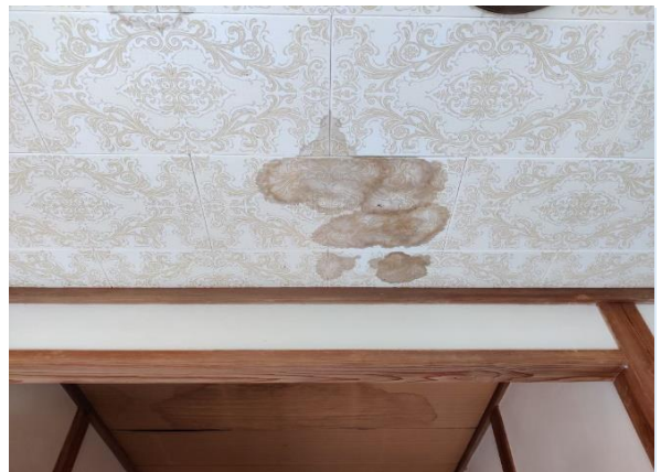
天井のシミ（一部）
