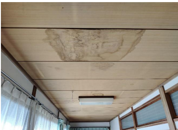
天井のシミ（一部）
