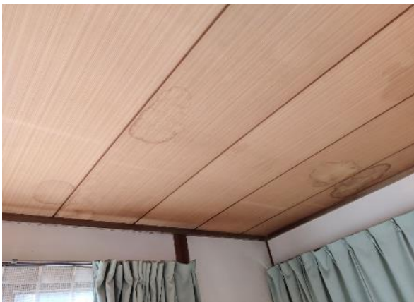
天井のシミ（一部）
