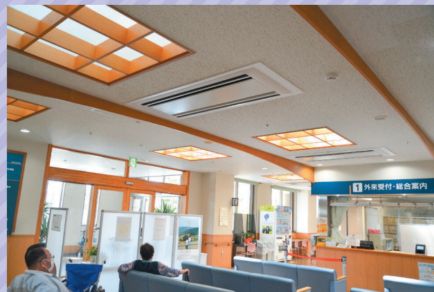
町立太良病院空調更新工事
