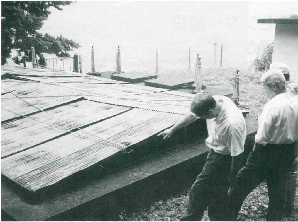
水源地の屋根は老朽化がひどい
