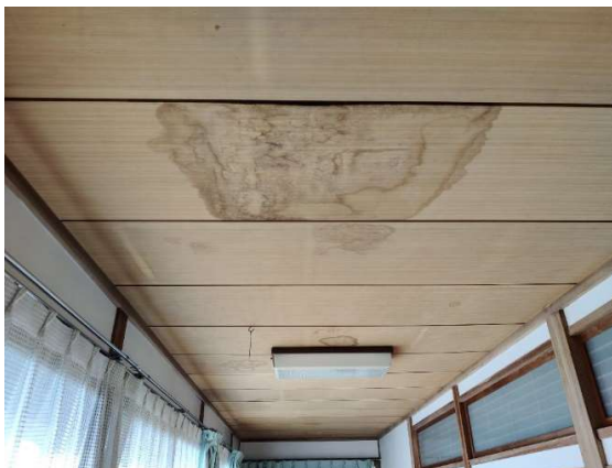
天井のシミ（一部）
