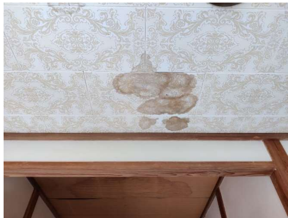
天井のシミ（一部）
