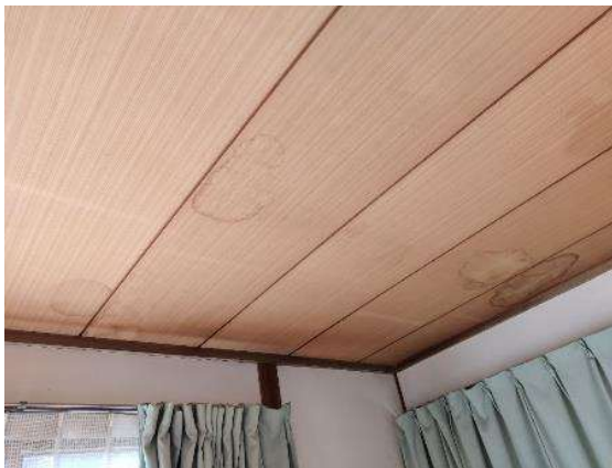
天井のシミ（一部）
