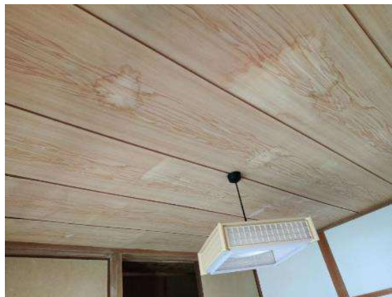
天井のシミ（一部）
