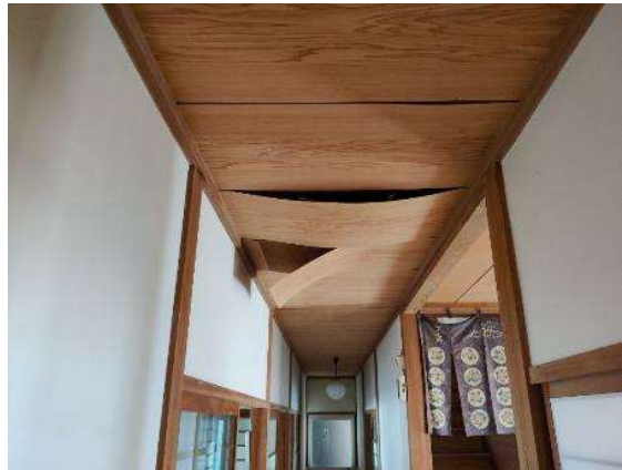
天井の剥がれ
